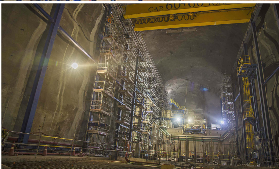
Construcción de la sala de transferencia principal entre las dos correas de transporte subterráneo. Gentileza cc PMChS Codelco 2018.
